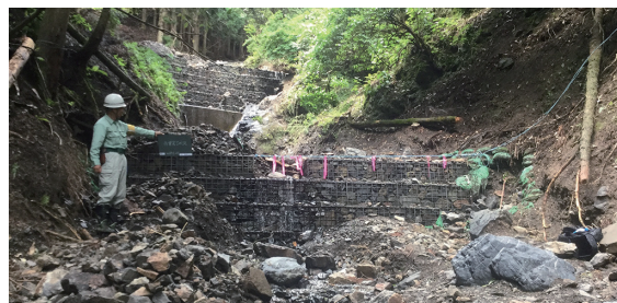
写真-2 監視機器（土石流センサー）設置状況
