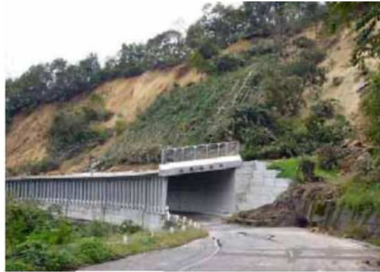
図 3.1.5 法枠工の被災事例－1 (62 地点: 東京電機大学安田教授提供)
