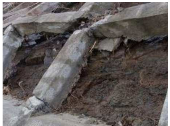
図 3.1.4 法枠下部の損傷(国総研, 2011) (金網型枠内のモルタルも破碎)
