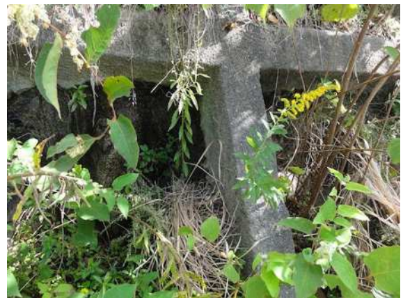
図 3.1.12 交点部分背後の空洞
