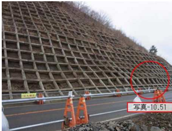
図 3.1.1 吹付法枠工の被災箇所(全景) (国総研, 2011)
