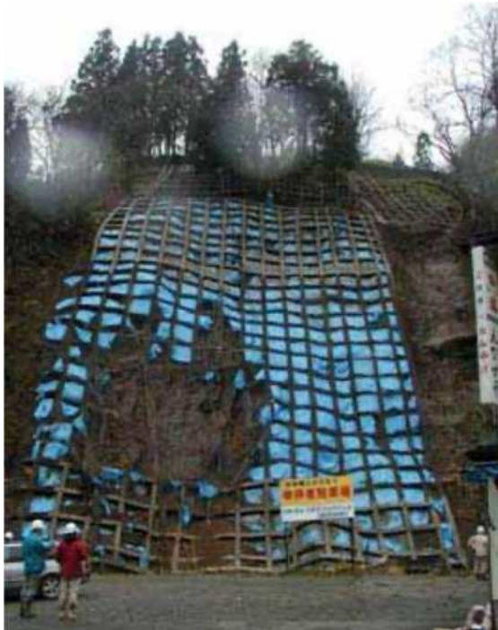
図 3.1.7 法枠工被災事例(50 地点:04.1.28)
