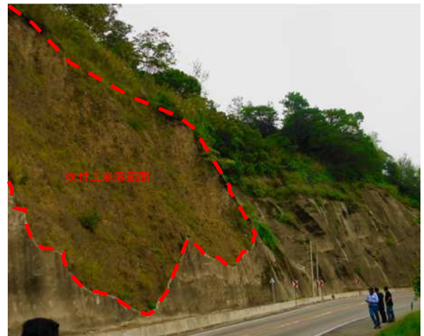
図 1.2.6 老朽化した吹付工被災事例例
