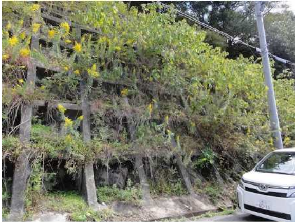
図 3.1.9 基盤風化に伴う吹付法枠の変状 (全景)
