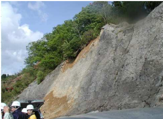
図 1.2.5 地震による吹付工被災事例
