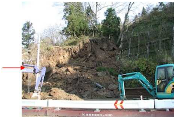
(a) 法枠工端部が崩壊しあ事例
