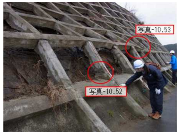
図 3.1.2 法枠の損傷箇所(国総研, 2011) (内部の吹付モルタルは、一部残ったがほとんどの部分で金網ごと流亡した)
