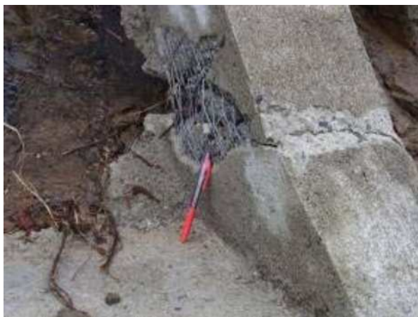
図 3.1.3 法枠下部の損傷(国総研, 2011) (金網型枠内のモルタルも破碎)
