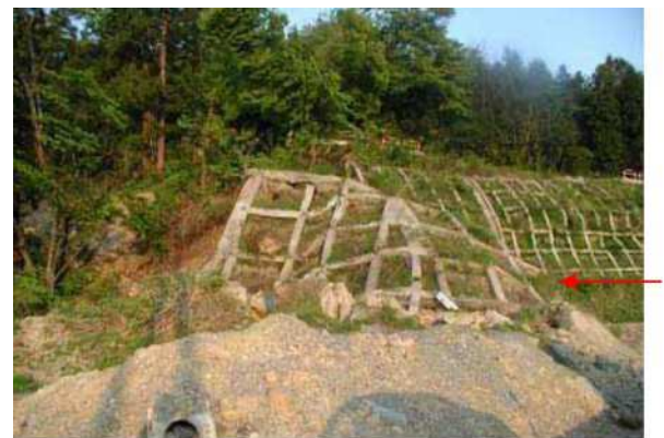
(b) 崩壊した法枠工端部の正面((a)矢印方向)
