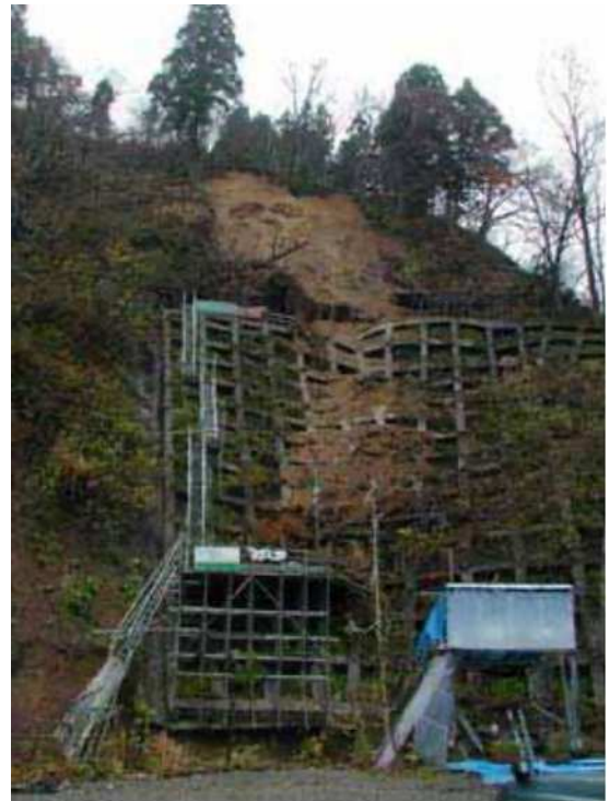
図 3.1.8 法枠工被災事例(50 地点:04.1.28)
