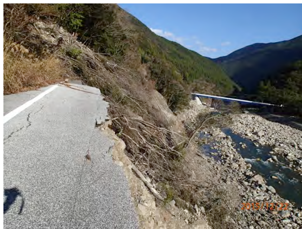
写真：被災状況
