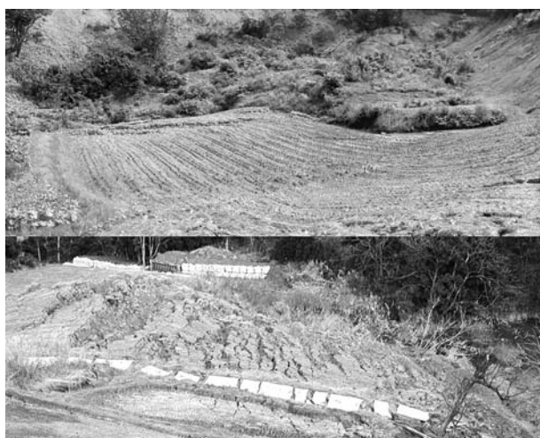
写真-2 水田表面の圧縮変形（上）と開口亀裂群（下）
