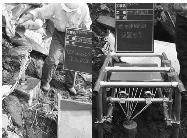
写真-7 測定不能後の孔内傾斜計内に設置した多層移動量計の事例
