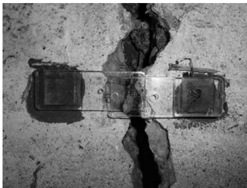
写真4.1.1 亀裂変位の計測
