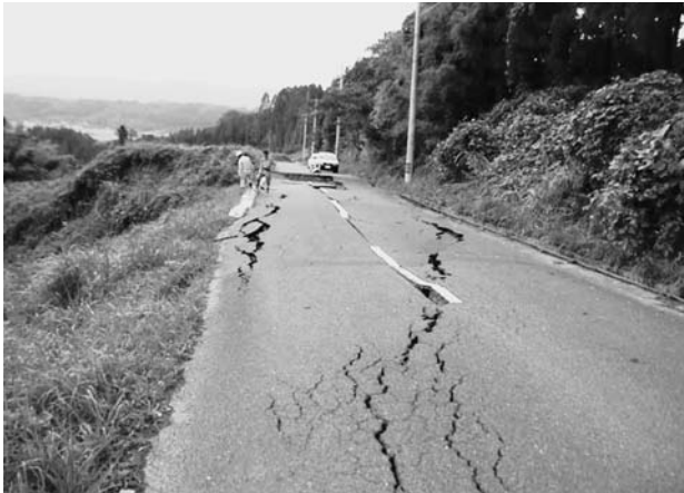
写真－２ 道路縦断方向に伸びる開口亀裂（地すべり頭部）
