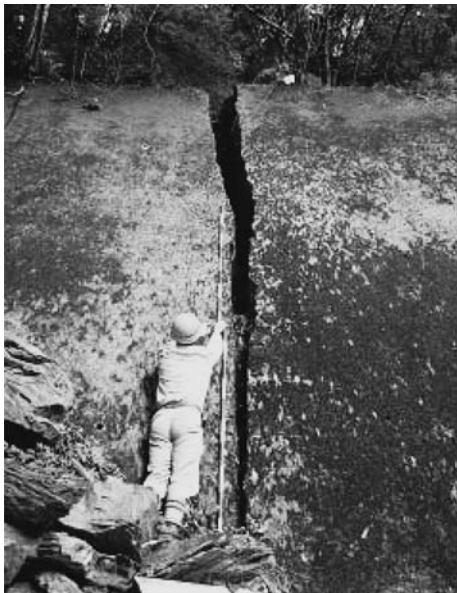
写真-9 擁壁のズレ亀裂（地すべり側部）
