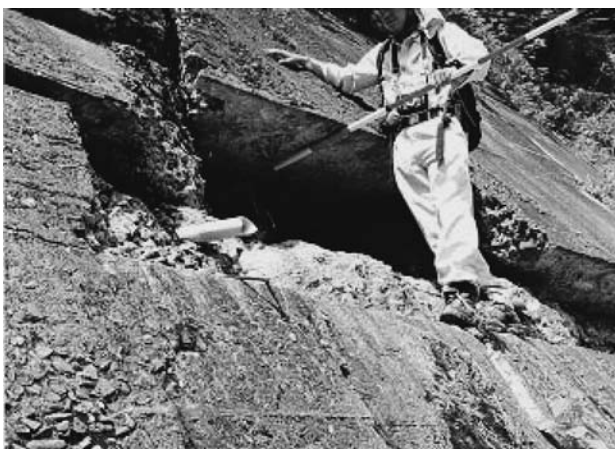
写真－３ 擁壁の水平亀裂（地すべり頭部）
