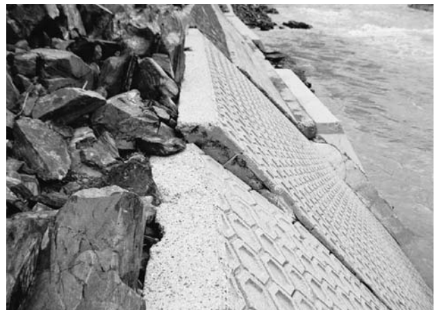
写真－６ 擁壁の起き上がり（地すべり末端部）
