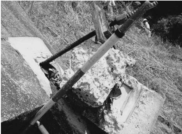
写真-11 破砕された頭部調整コンクリートと抜け出た tendon
