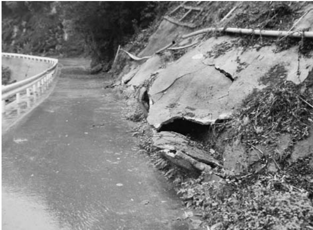
写真-7 モルタル吹付け部のせり出しと法尻の隆起（地すべり末端部）
