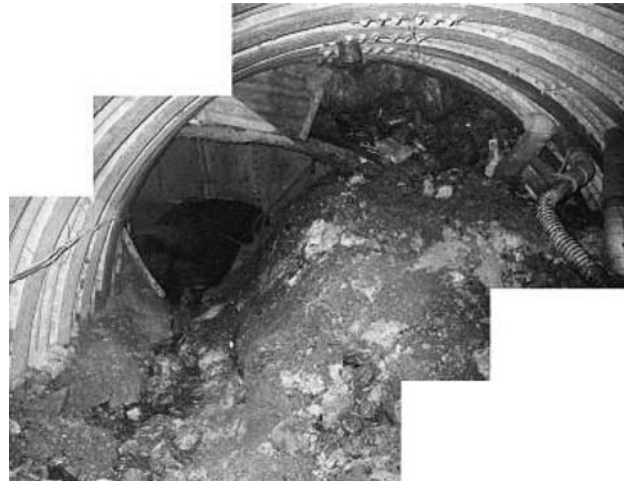
写真-13 地すべり滑動で変形した排水トンネル工とボーリング室に溢れ出た地すべり土塊の一部
