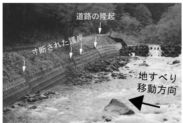
写真-7 川底を通過して対岸に隆起したすべり面。 地すべり地の主体は川の左岸側（写真では右側） （秋田県島海町）
