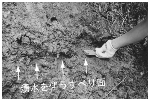
写真-6 斜面途中に見られる湧水を伴ったすべり面。 ここでは横方向に連続して確認される（秋田県五城目町）
