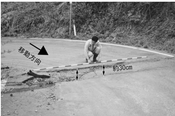
写真-4 地すべり末端部の隆起（秋田県島海町）
