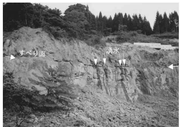
写真－1 河岸斜面の途中に出たすべり面 すべり面から湧水しているのが見られる（山形県大蔵村）
