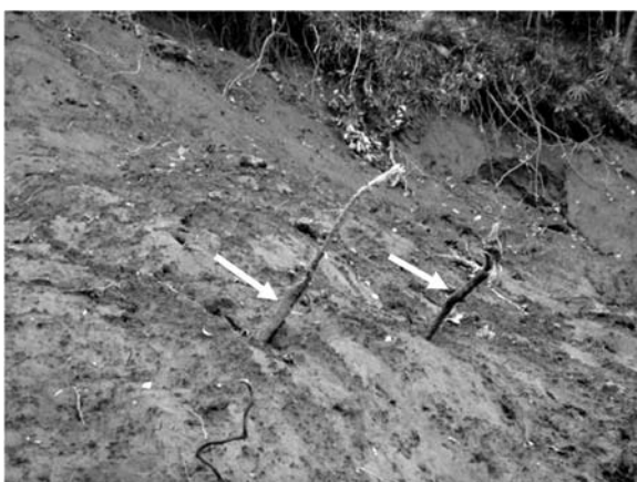
写真-4 せん断された樹木の根（崩壊部）
