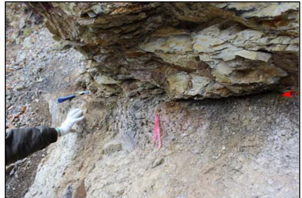
写真 3 上釜戸地すべりの頭部付近の層面断層
