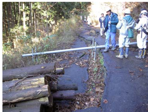
写真 2-2 頭部付近の路面段差滑落崖付近
