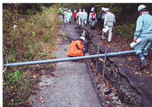
写真 10 頭部付近の路面段差
