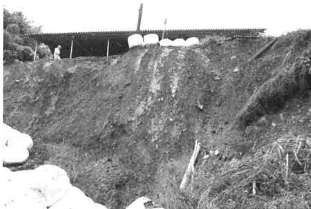
写真-1 頭部滑落崖の状況
