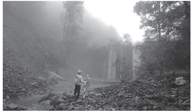
▲写真1 立岩砂防堰堤下流側の溪岸崩壊
