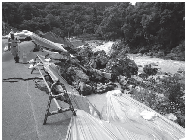
◀写真3 柳淵地すべり末端部の被災状況
