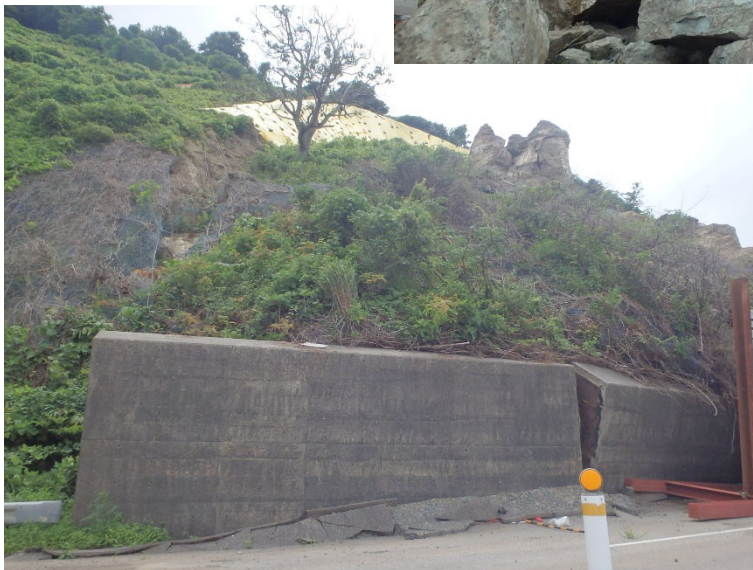
藤島由良線地すべり状況
