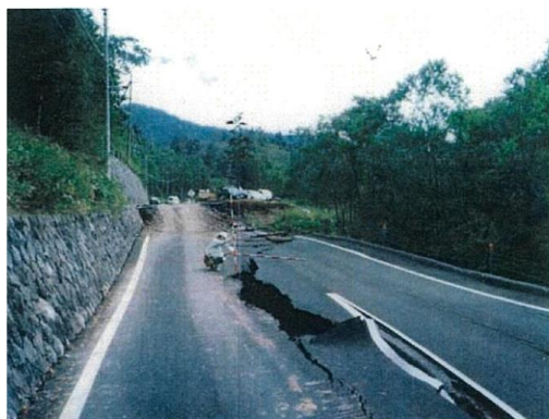
万座ブロック頭部に発生した亀裂
