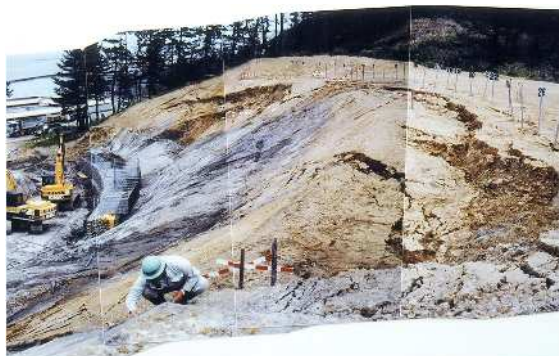
図 16 3) (上) 不安定化が止まない切土のり面(流れ盤斜面)
