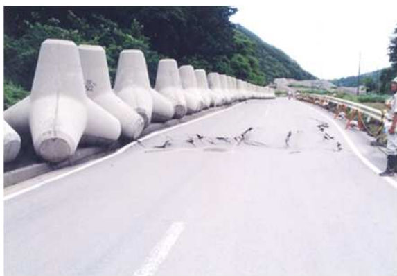
図 20 11) 変状の初期, 7/10 の状況(6/30 に変状発見)
