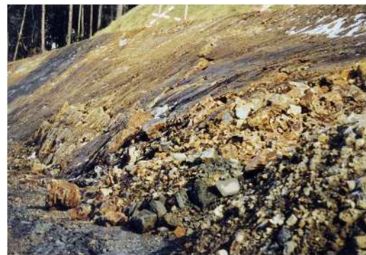
図14 応力解放による盤ぶくれで変形した切土のり面
