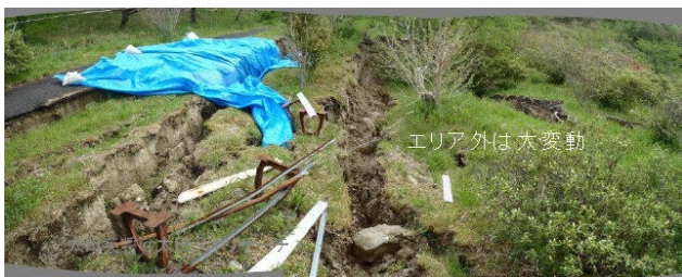
写真4 集水ボーリング到達外の大変動
