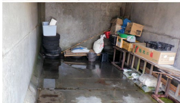
写真3 全てのガレージの奥に水が溜まった
