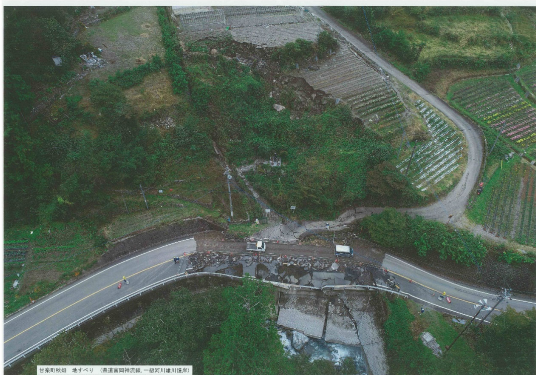
河振地すべりの令和元年の台風 19 号による被災状況
