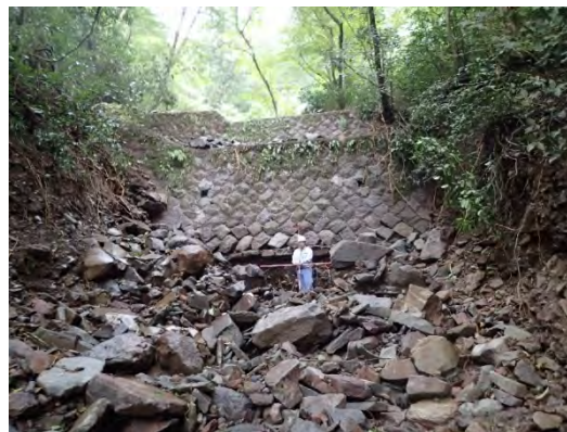
写真 4-2 被災した既設の谷止工（増厚及び根継を計画）
