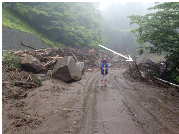
写真1 前橋市富士見町の林道被災状況
