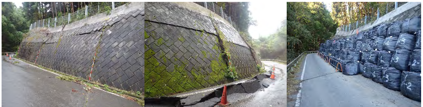
写真 2-3：末端道路擁壁の変状 写真 2-4：末端道路擁壁、路面の変状 写真 2-5：大型土嚢設置状況
