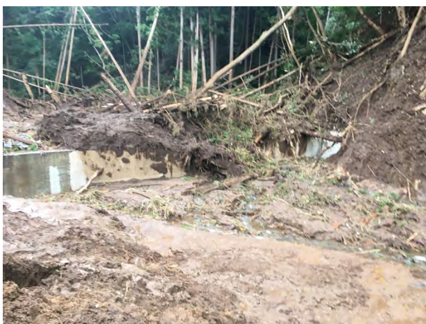
図8 図7の上流にある堰堤の堆積土砂（この奥に湛水）（10月14日11時頃）
