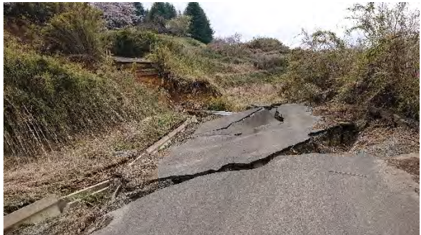
写真 1-3：富岡市道の被災状況
