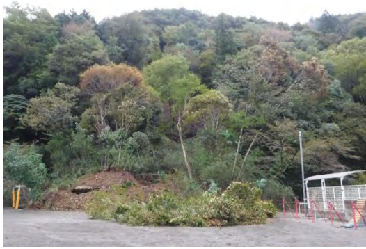
写真 2-1 発災後の崩壊地の状況
