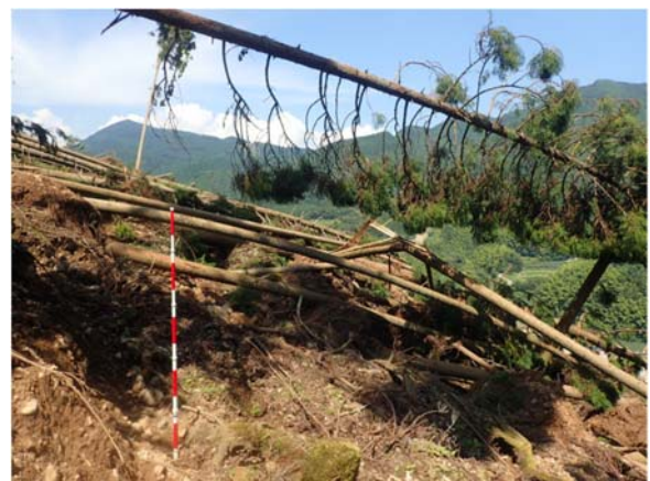
写真-4 崩壊斜面上部の緩斜面部における段差地形（7/13 撮影）
