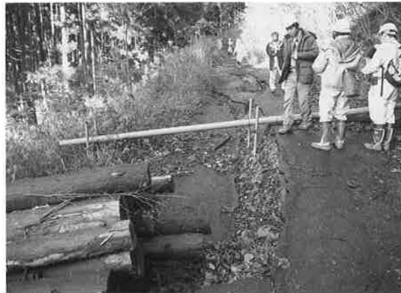
写真2 頭部付近の路面段差滑落崖付近
