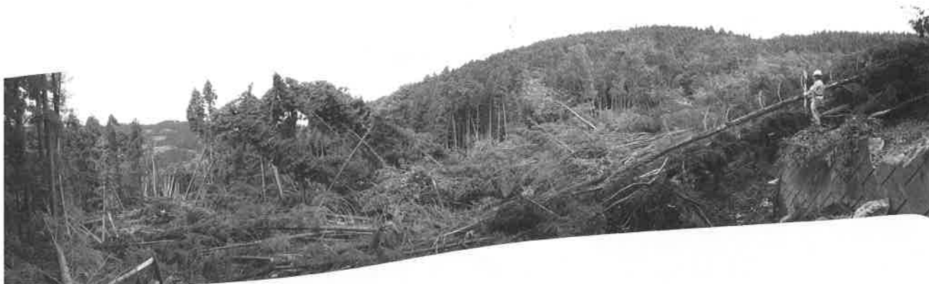
写真-8 左側壁からみた地すべり地内の状況(崩積土層の移動と傾倒木被害)
