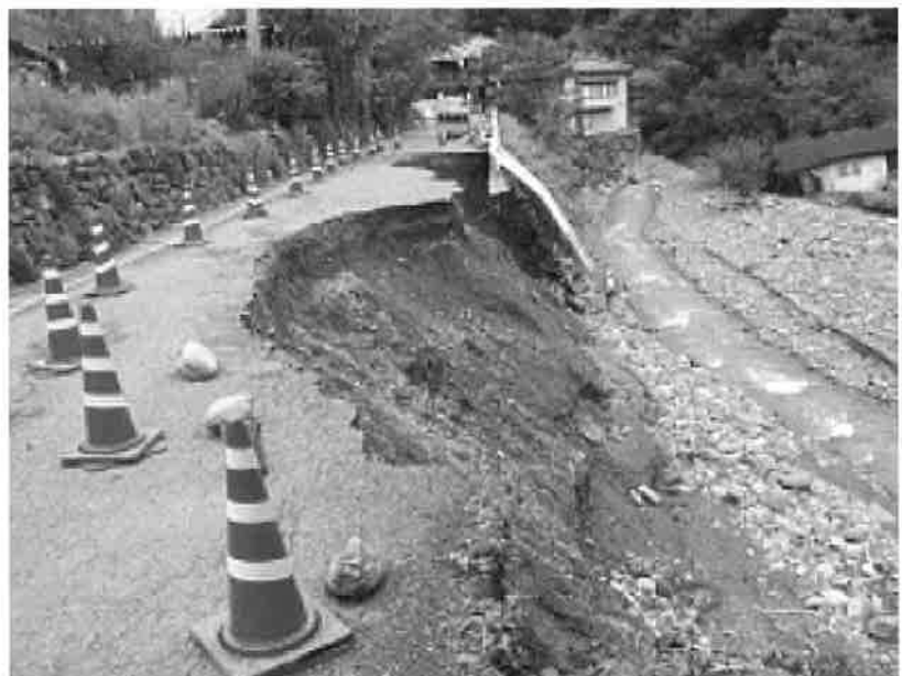
写真-1 河流による側部・底部の洗掘または道路面からの流下水による崩壊
