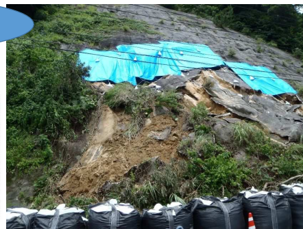
モルタル吹付斜面の崩壊
