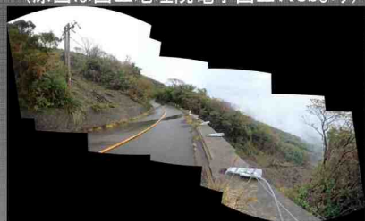
崩壊斜面下方の道路 (H26.11.1撮影,土砂撤去後)
