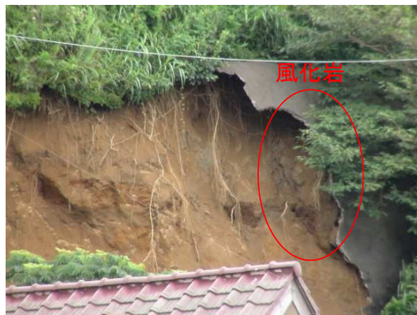
モルタル吹付の崩壊状況
