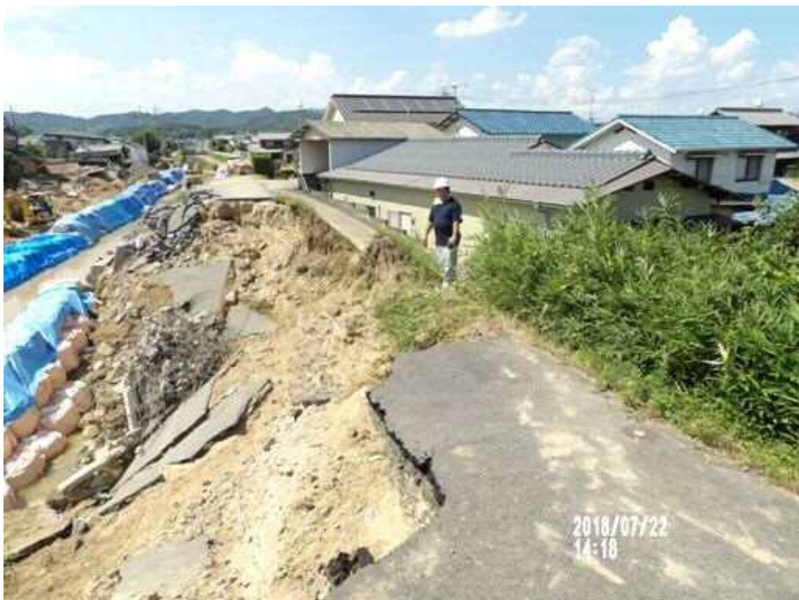
写真2 末政川の左岸堤防のすべり破壊（速報の写真-5の地点6）
