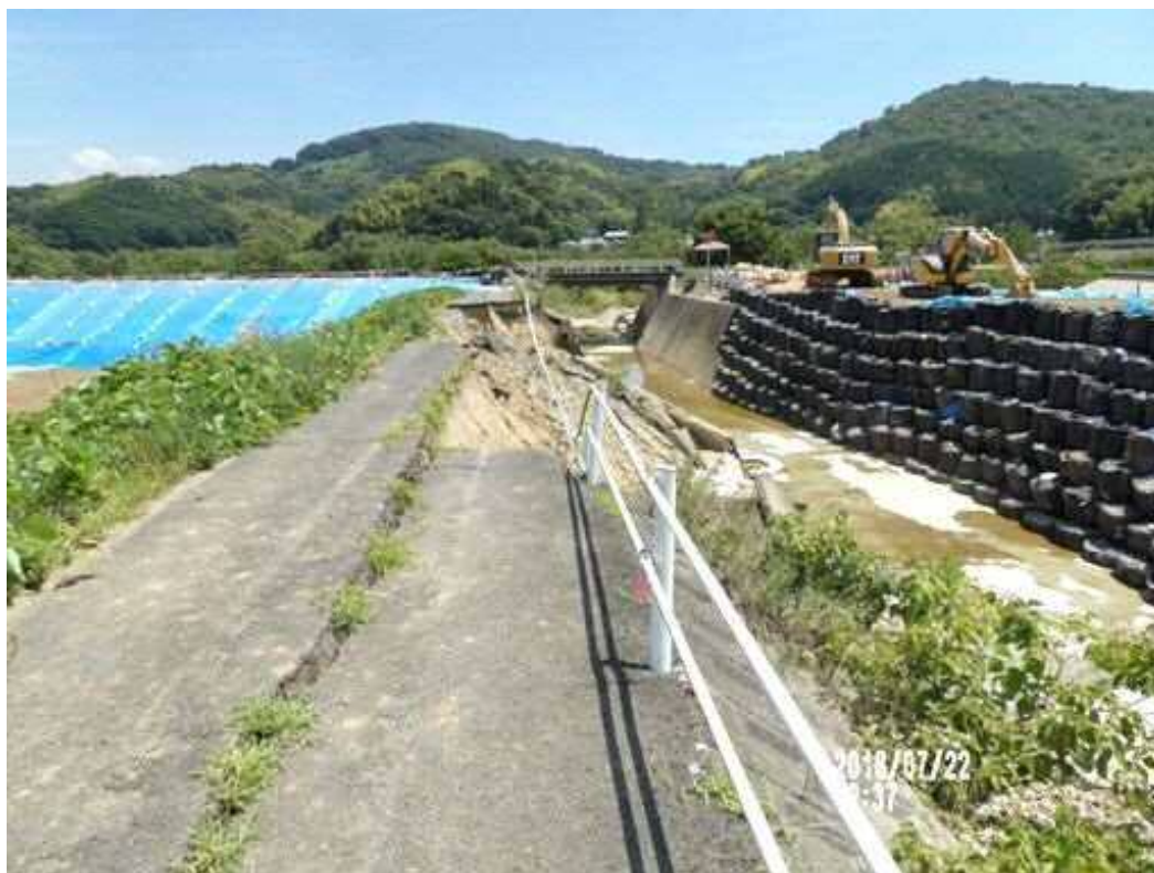
写真1 高馬川下流の破堤（右岸）と堤防表法面のすべり破壊（左岸）
