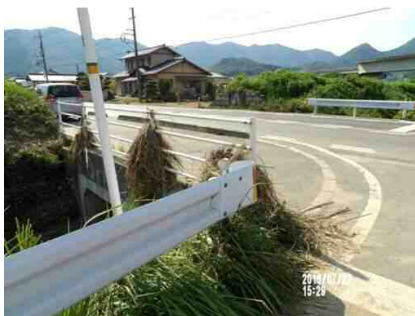
写真－9 内山谷川の国道486号線橋梁の欄干に溜まったゴミ（手前が下流；筆者撮影）
