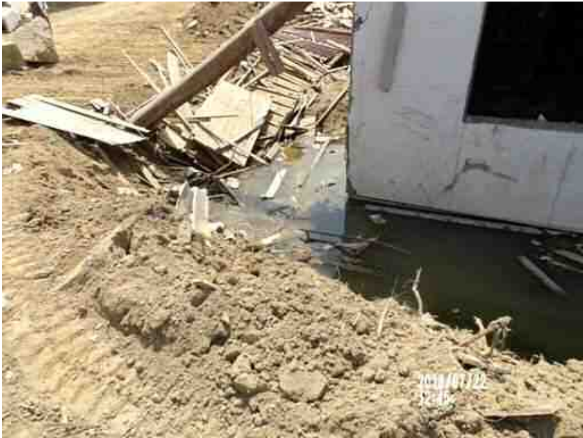
写真－４ 傾いた家屋の基礎部分のクローズアップ（地点１にて筆者撮影）
