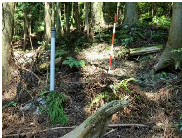
写真3 千本地区地すべり末端の段差
