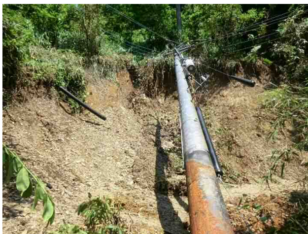
写真4 千本地区地すべり東側の斜面崩壊
