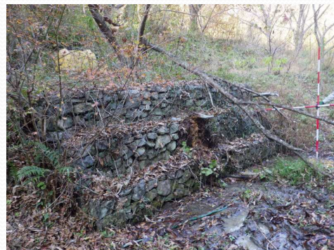
流末処理未施工
