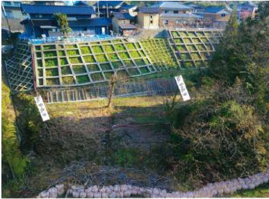
○アンカーの浮き上がりが発生
