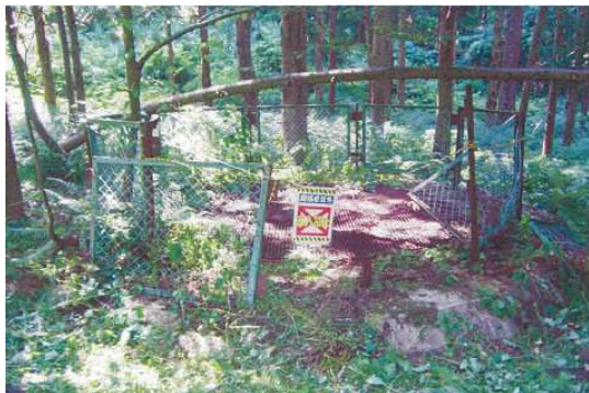
○積雪による立入防護柵の破損
