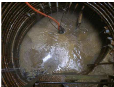
○集水井内の湛水、排水ボーリングの機能停止
