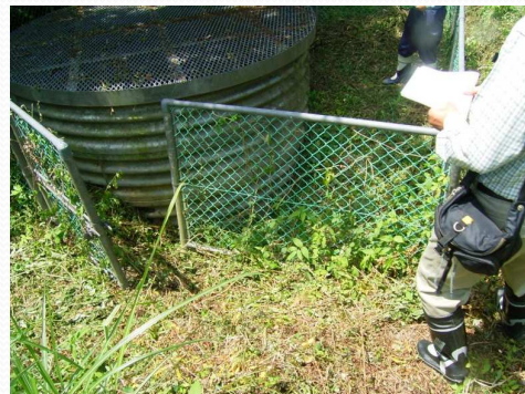
井筒の傾倒（沈下）
