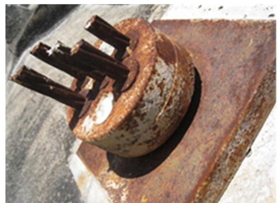
図-3 グラウンドアンカーの腐食
