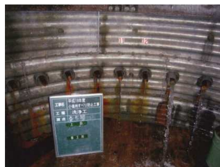
○集水ボーリング目詰まりにより集水機能の低下
