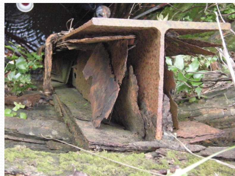
バーティカルスティフナー腐食
