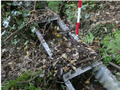
枯葉・土砂堆積（水路工）
