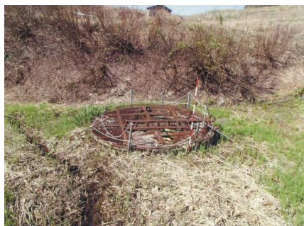
○天蓋が腐食し、穴が開いた状態
