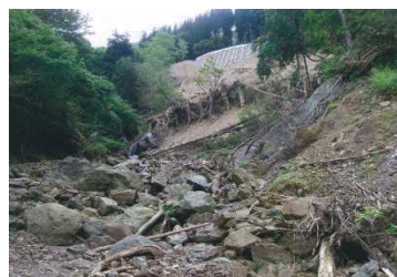
○杭工の一部露出、変位
