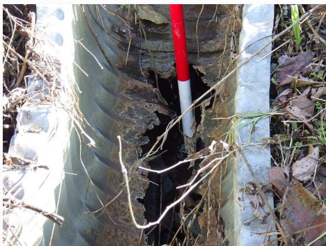
U字フリーム腐食
