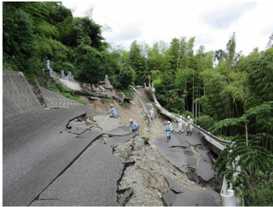
写真-16 崩壊ブロック頭部
