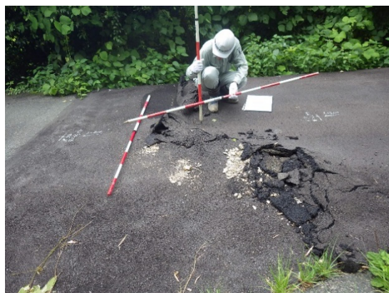
写真-5 側部亀裂
