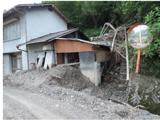
写真-17 土石流で被災した家屋
