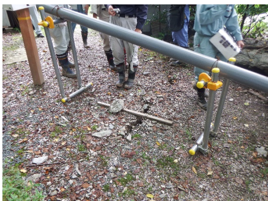
写真-6 道路直上の亀裂と伸縮計
