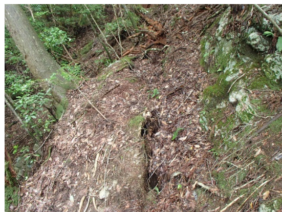
写真-13 旧滑落崖より上方の開口亀裂
