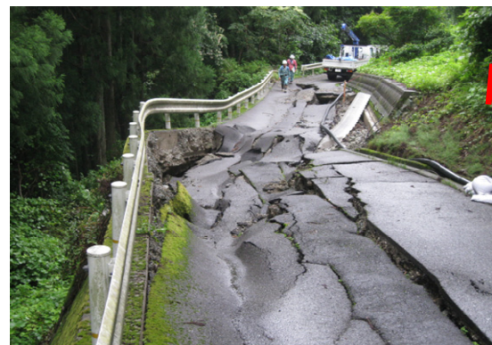
写真-15 道路の変状
