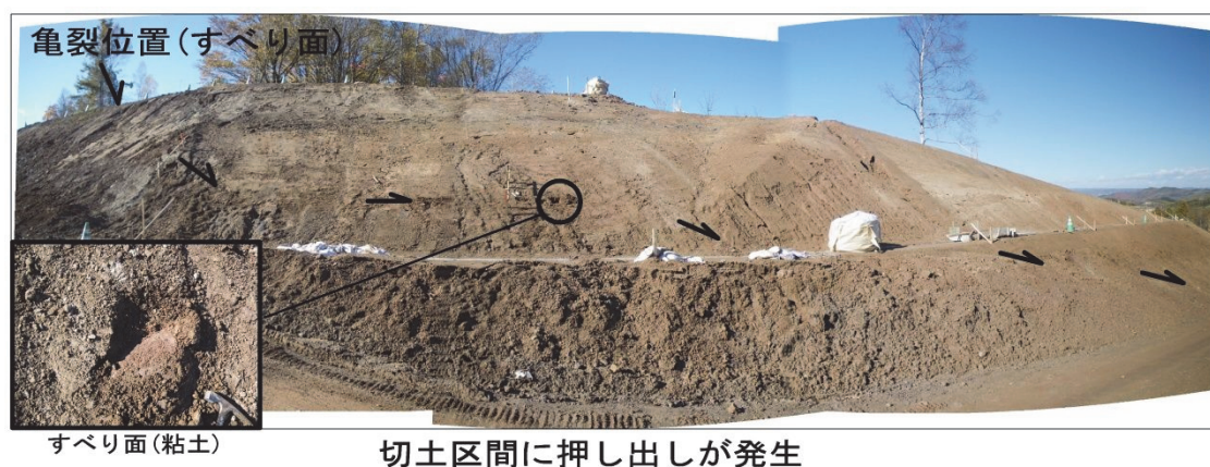
写真-11 切土面の押し出し区間と亀裂位置（法面背後の地すべりのすべり面）
