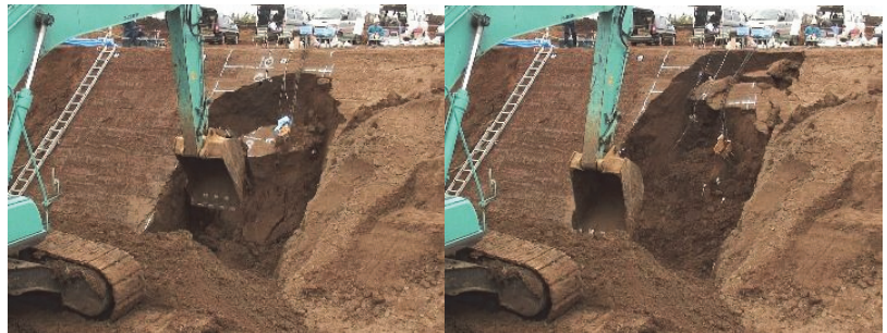
(b) 2 回目崩壊（連続的に法肩まで崩壊）
