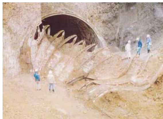
図— 1 5 斜面崩壊による支保工の変状
