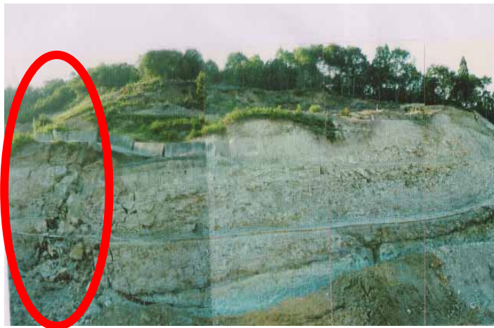
図 3 - 2 切土のり面の崩壊（左部の崩壊が著しい。）
