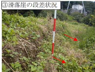
③滑落崖の段差状況
