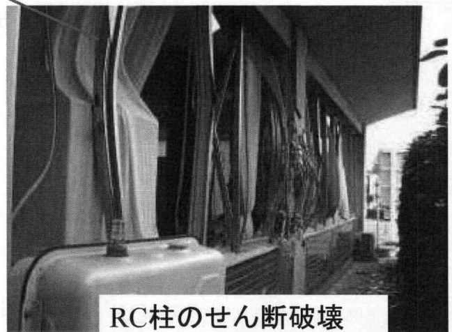
須賀川市役所の被害
