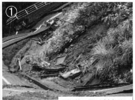
国道8号が被災
