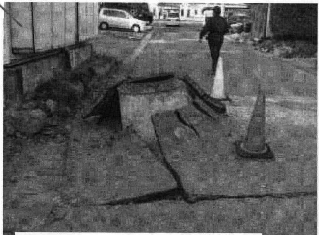
マンホールの浮き上がり
