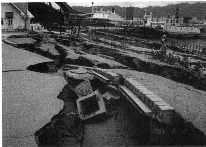
液状化による側方流動 (ポートアイランド)
