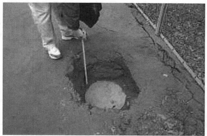
40cm以上堆積, この道路に顕著なマンホールの浮き出しは見られない
