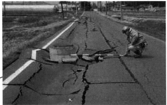
マンホールの浮き上がりと道路陥没
