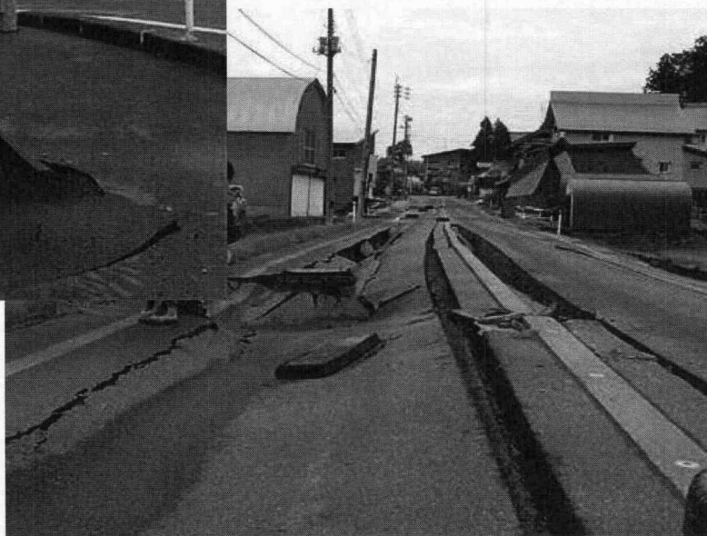
埋め戻し部の陥没 (小千谷市)
