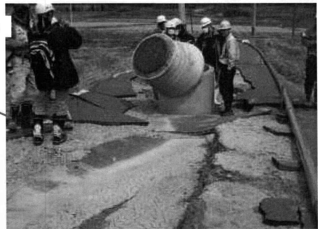
埋設深が深いものは浮き上がり大
