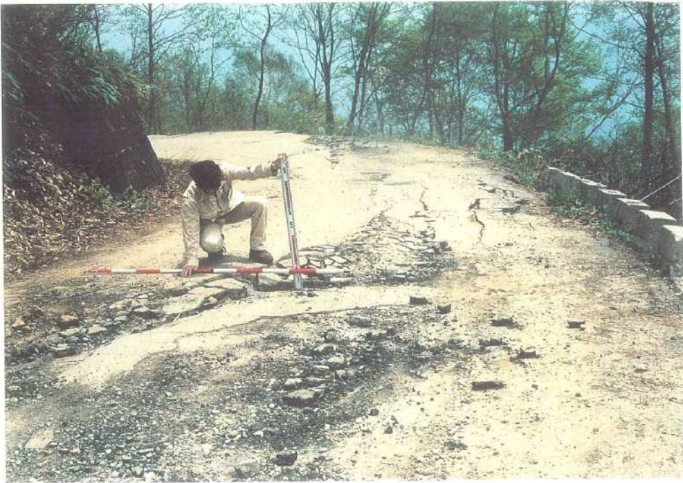
④-2 H8.5 同所 段差を伴う亀裂、亀裂が発生。
