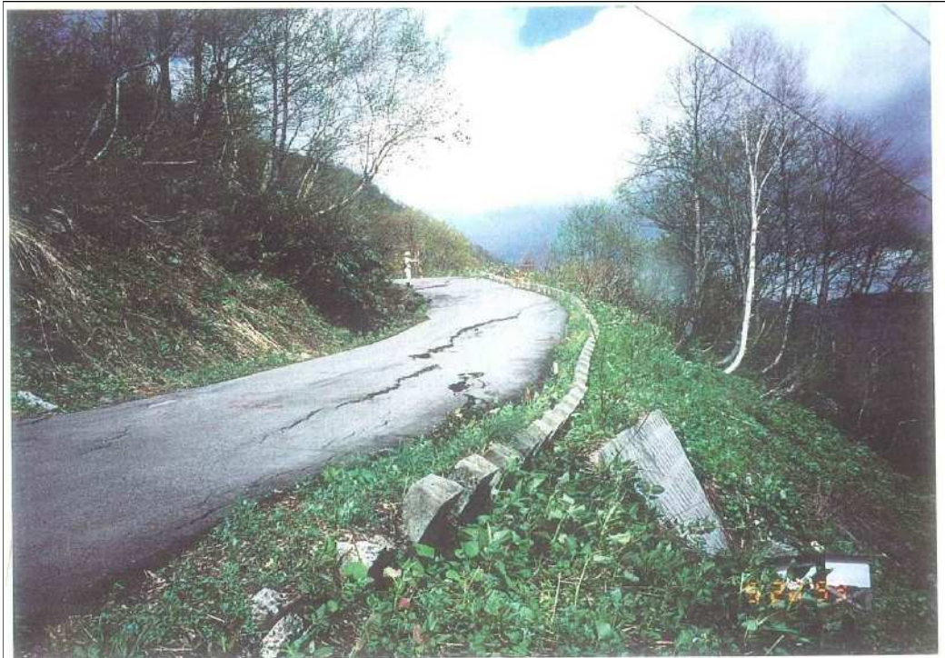
⑤-4 H11.5 H8、H10を結ぶような亀裂が発生。
