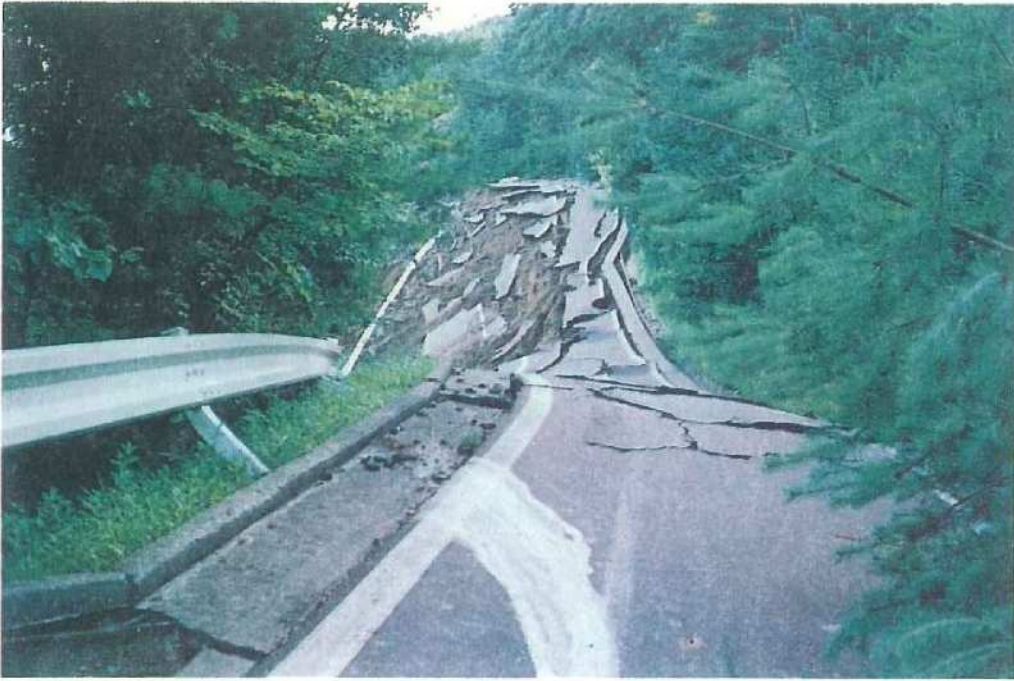
25：1 km付近，大崩落時の状況 その1（上村靖雄氏撮影）
