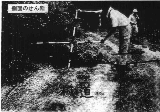
末端部側面のせん断破壊
