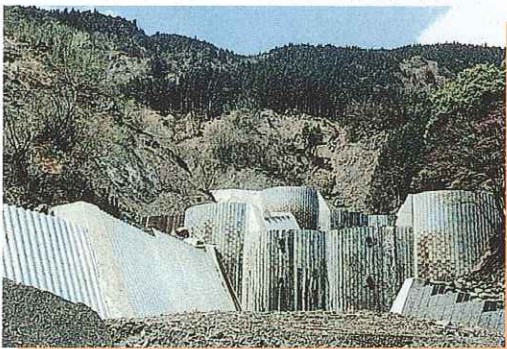
鋼製砂防ダム
