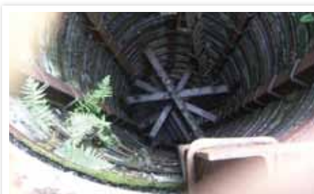
ラテラルストラットで補強された集水井
