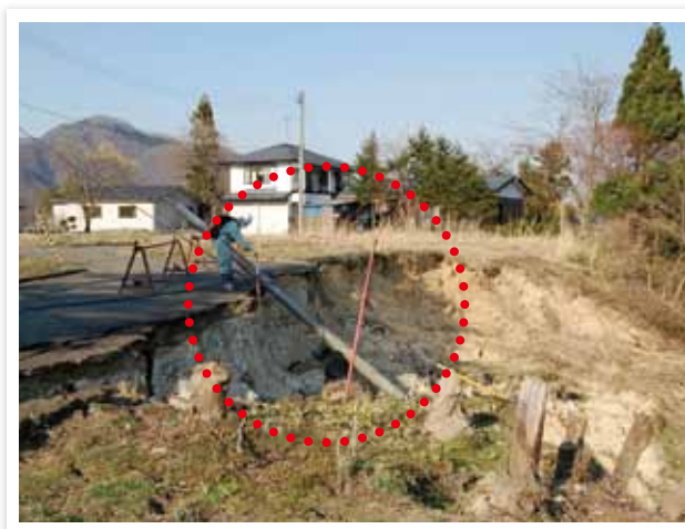
地震による地すべり発生（仙台市青葉区） すべり面は地山の第三紀火山岩類と崖錐を巻き込み滑動中
