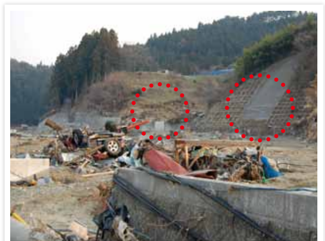
津波被害と線状痕（陸前高田市） 津波により、擁壁モルタル表面に瓦礫が激突し、線状痕を確認。隣接した急傾斜施設は倒壊・破損
