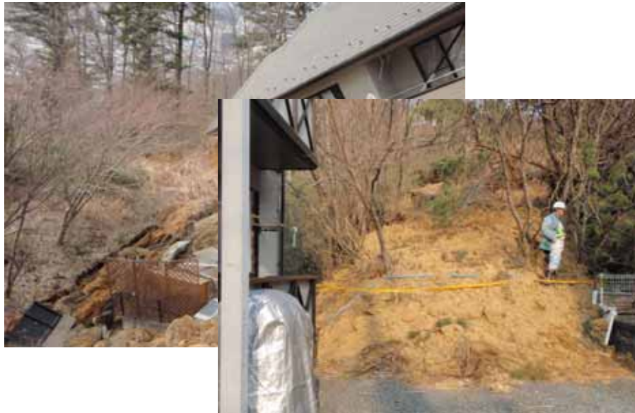
仙台市青葉区 西花苑1丁目の地すべりと土砂の斜面 下側宅地への流下(凝灰質砂の流動化)
