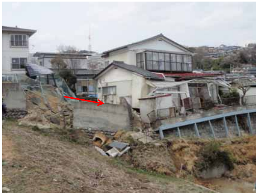
盛土斜面の地すべり (近傍で多量の湧水が見られる) (仙台市太白区青山2丁目)
