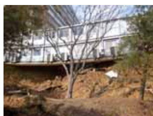
東北大学工学部構内の谷埋め盛土地すべり頭部
