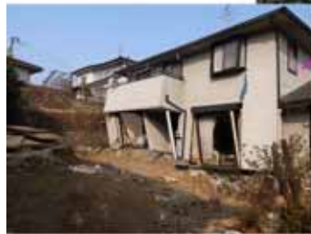
末端部の隆起による家屋の被害
