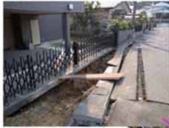
護岸左翼の引張割れ目
