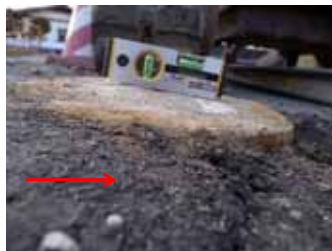
傾斜した杭頭
