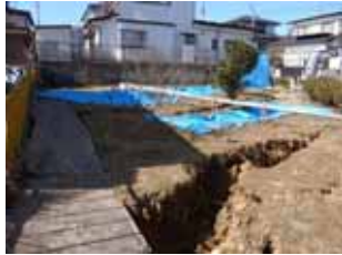
緑ヶ丘3丁目地すべり頭部
