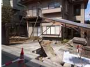
緑ヶ丘4丁目地すべり頭部
