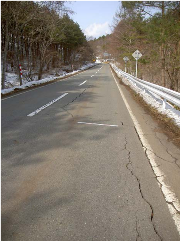
写真-1 道路盛土部分の崩壊 (踏査路線全線でこのような道路路肩の亀裂が見られる)
