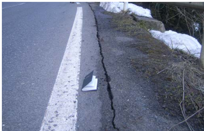
写真 4 崩壊箇所手前の路面の亀裂
