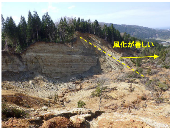
写真 5.3.5 西側側方崖斜面
