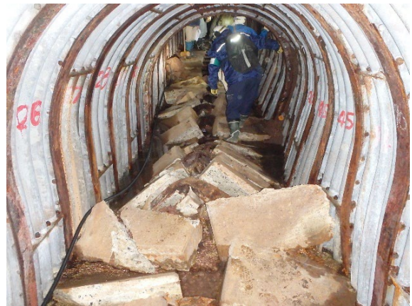
写真 5.3.16 排水トンネルの変形 坑口付近の底盤コンクリートの変形が大きい。
