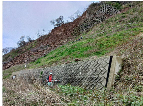
写真 5.3.14 ブロック積擁壁変状 排水トンネル坑口土留め擁壁は押し出し変形が認められる。
