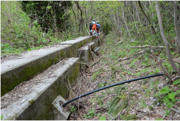
写真 5.1.1 抜け出したアンカー
