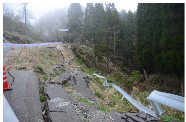
写真 5.1.15 道路法肩の崩壊
