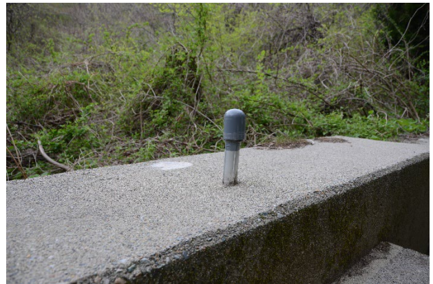
写真 5.1.4 受圧板に設置された孔内傾斜計
