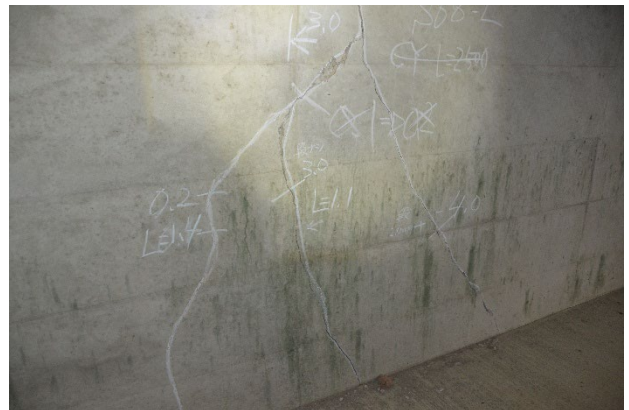
写真 5. 1. 35 地すべり左側側部の変状に伴う亀裂
