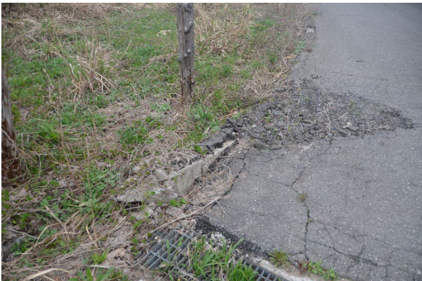
写真 5.1.12 側溝に生じた変状。
