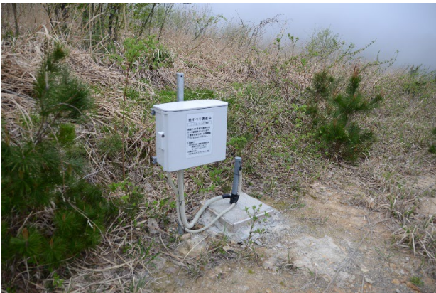
写真 5.1.11 パイプひずみ計（地すべりブロック外）
