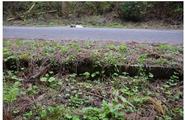
写真 5.1.13 側溝に生じた変状
