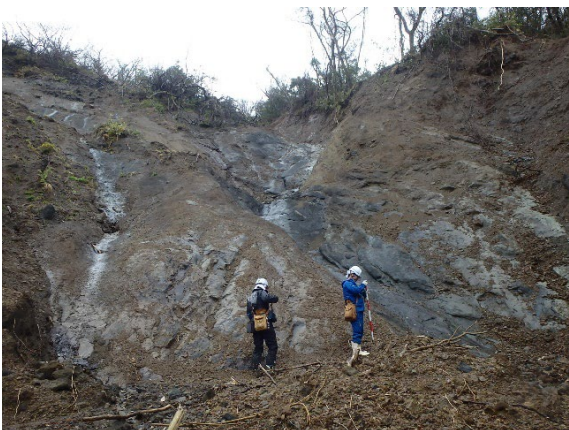
写真 5.3.21 崩壊斜面状況 層理面すべりが発生している。
