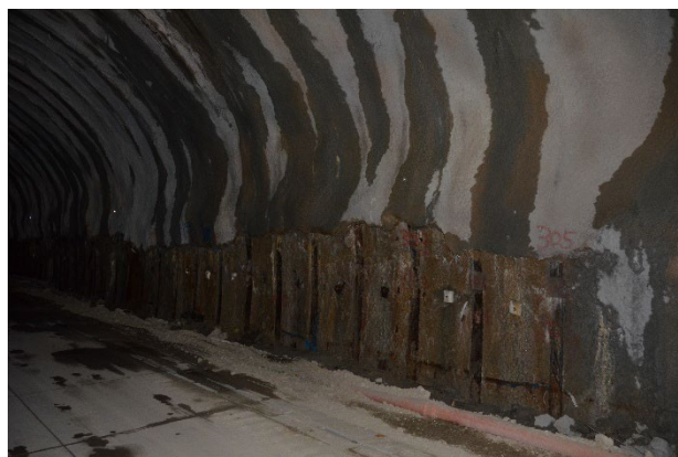
写真 5.1.29 ハツった後に再度吹付けされた変状箇所
