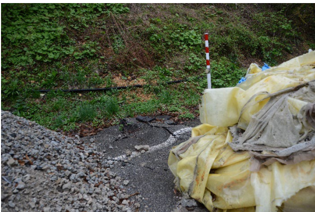
写真 5.1.22 坑口付近の道路亀裂
