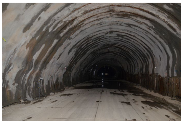
写真 5.1.28 せん断変形による支保工の変状
