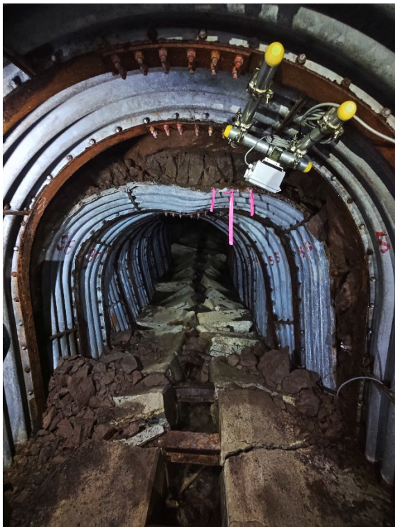
写真 5.3.17 ライナープレートの変形 坑口側が落ちており、地すべり背面のせん断変形の可能性がある。
