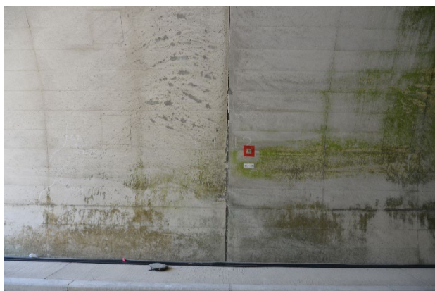
写真 5.1.25 坑口周辺の目地のズレ
