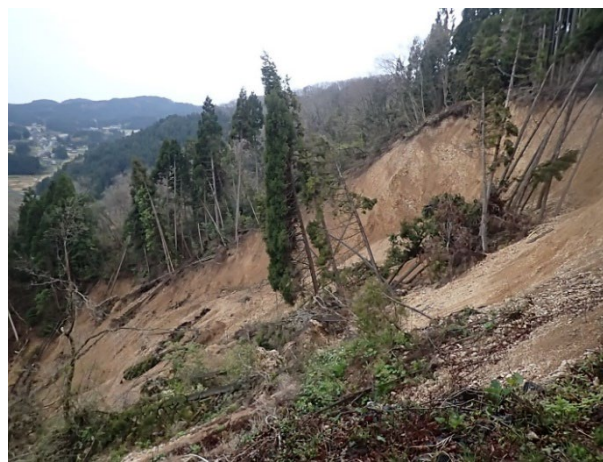
写真 5.2.5 1 月の地震で発生した拡大性の地すべり性崩壊（位置は図 5.2.2 の②）
