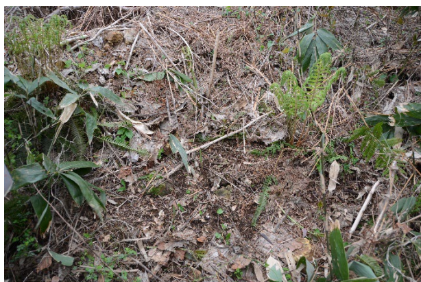
写真 5.1.10 段差と亀裂の連続性を確認
