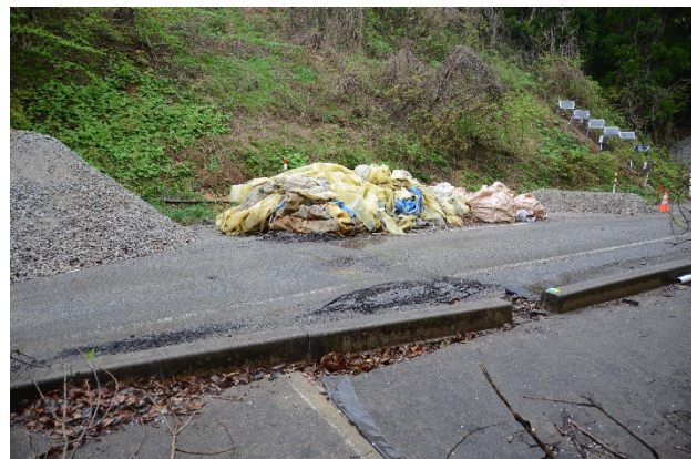
写真 5.1.23 坑口付近の道路亀裂
