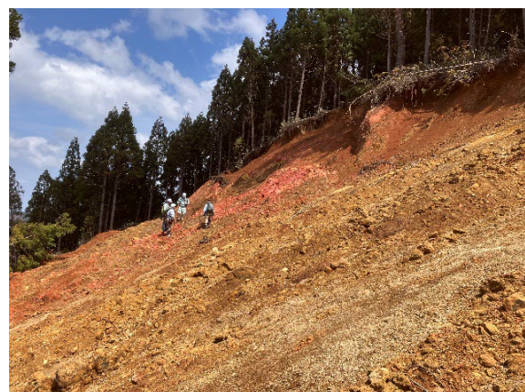
写真 5.3.4 地すべり頭部付近の状況 滑落崖の一部には粘性土状に風化した赤色の軽石凝灰岩が分布する。
