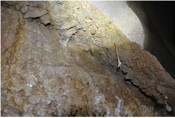
写真 5. 1. 30 変状が生じた箇所の地山状況 (土砂山)
