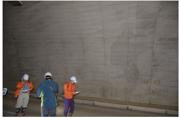
写真 5. 1. 33 地すべり左側側部の変状に伴う亀裂
