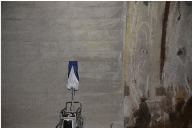
写真 5. 1. 31 地すべり区間の境界部
