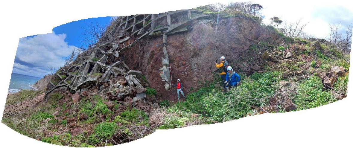
写真 5.3.15 崩壊頭部全景 鉄筋挿入工併用の吹付法枠工が滑落崖で破断している。
