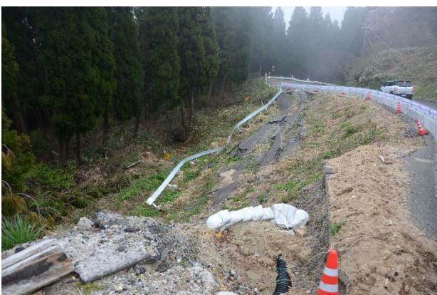
写真 5.1.14 道路法肩の崩壊
