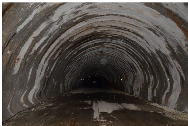
写真 5.1.27 せん断変形による支保工の変状
