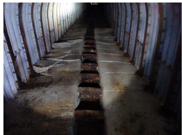
写真 5.3.18 底盤コンクリートの変形 坑口付近より山側で変形が認められており、国道背後のすべりの可能性がある。
