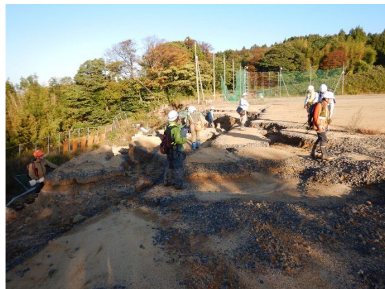
写真 5.3.14 段丘面にみられる地すべり による変状 ただしこの斜面は造成地の盛土である。
