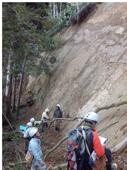
写真 5.3.21 崩壊の滑落崖の状況
