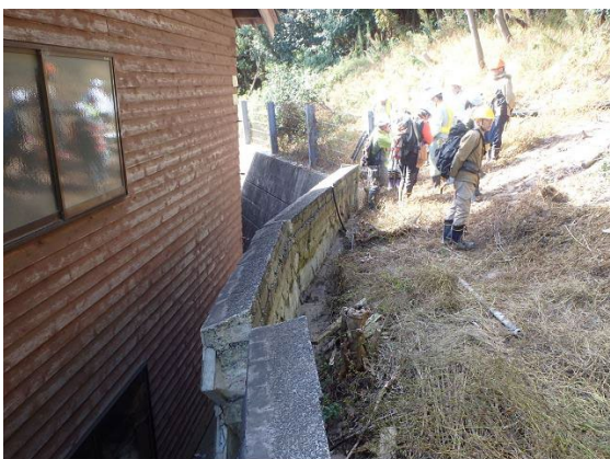
写真 5.3.17 地すべりによる変状
