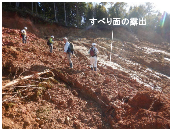
写真 5.3.3 地すべり頭部付近の状況 土塊流失により、すべり面が露出している。すべり層厚は下部に比べ浅い。
