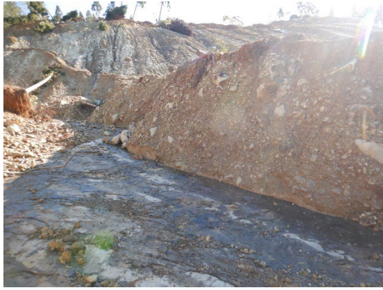
写真 5.3.4 基盤岩及びすべり面の露出
