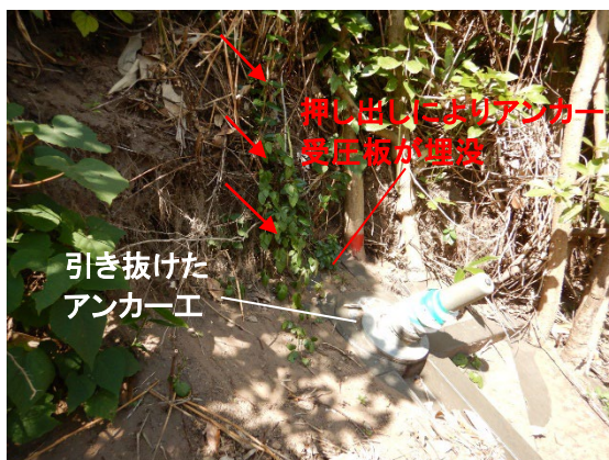
写真 5.3.18 既設アンカー工の引き抜け箇所
