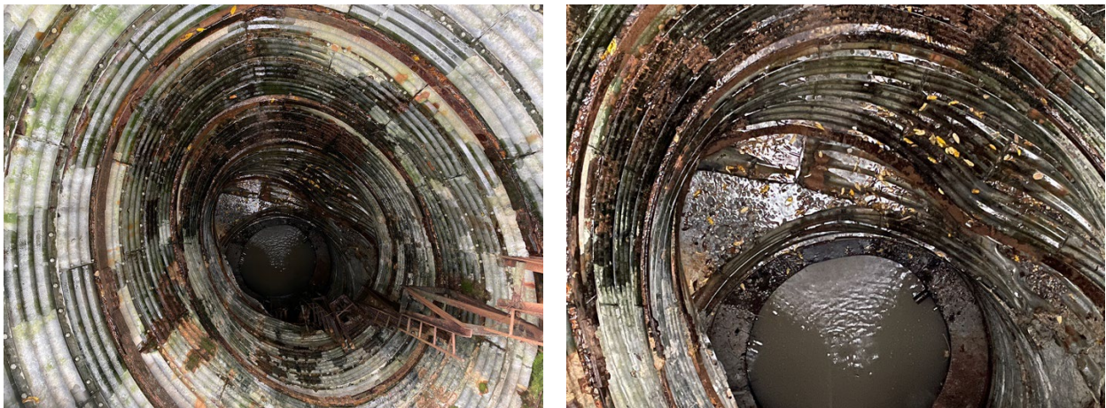
写真 4-2 集水井の変形状況
