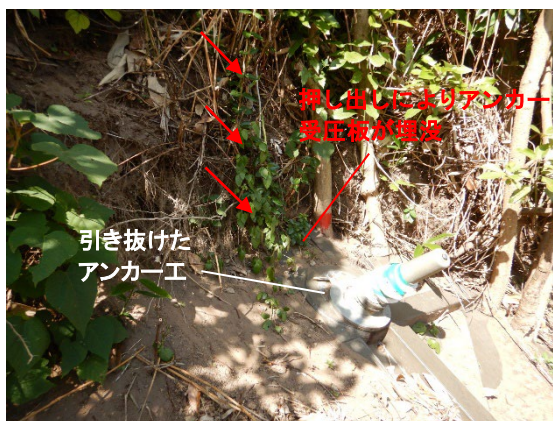
写真 5.3.18 既設アンカー工の引き抜け箇所
