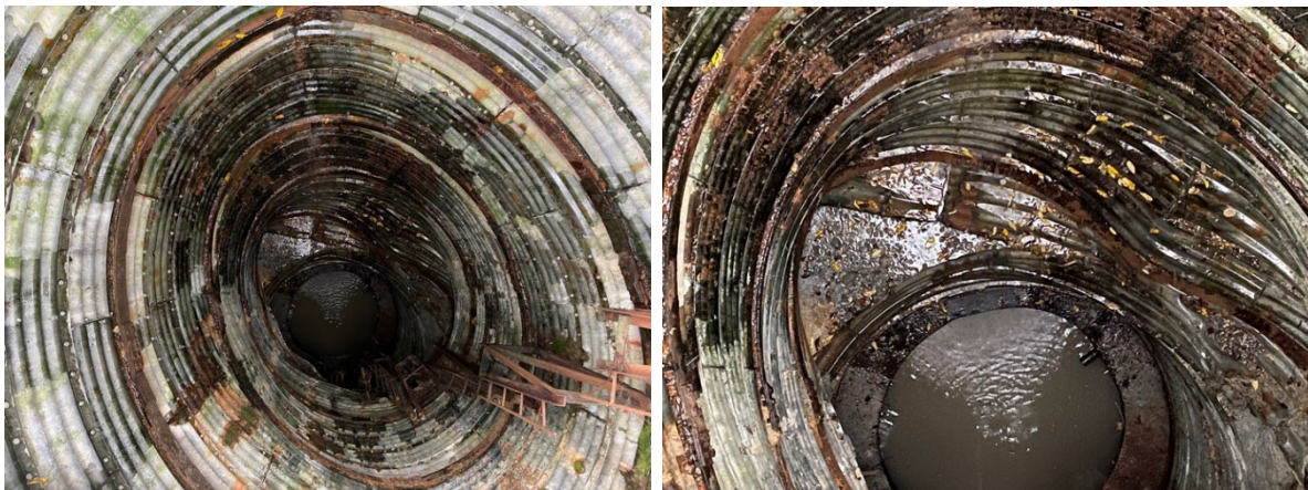
写真 5.1.10 集水井の変形状況
