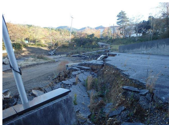
写真 5.3.13 段丘面にみられる地すべり による変状
