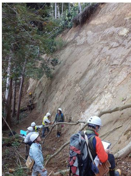
写真 5.3.21 崩壊の滑落崖の状況
