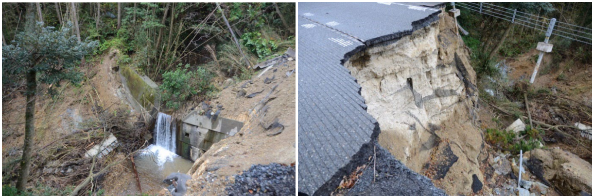
写真 5.1.4 土石流による侵食によって生じた崩壊
