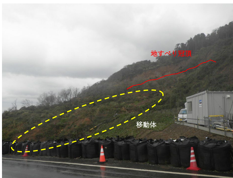
写真 5.2.5 踏査時の地すべりブロック状況
