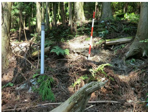
写真3 千本地区地すべり末端の段差
