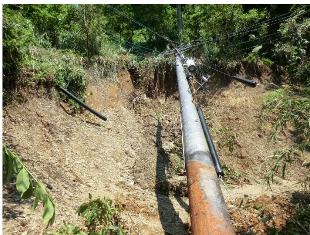
写真4 千本地区地すべり東側の斜面崩壊
