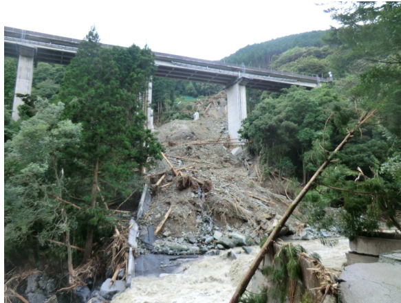
写真1 真下から被災区間を見上げる
